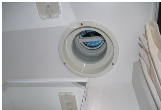
シャワー室ベンチレーター
